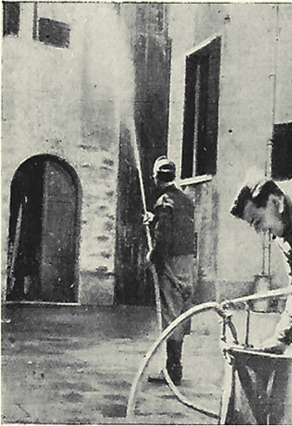
La pompa monocilindrica in funzione con l'aggiunta dei tubi.
