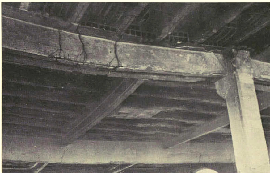
L'effetto dell'alta temperatura in una trave in cemento armato.
