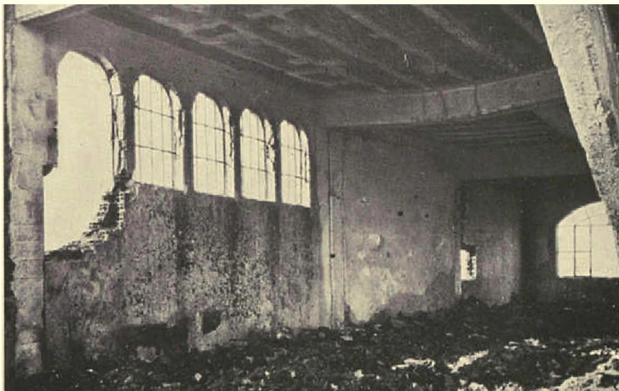
Effetti dell'incendio sulle travature in cemento armato e sui laterizi forati del soffitto. Notare le inflessioni, le screpolature, e i ferri messi a nudo.
