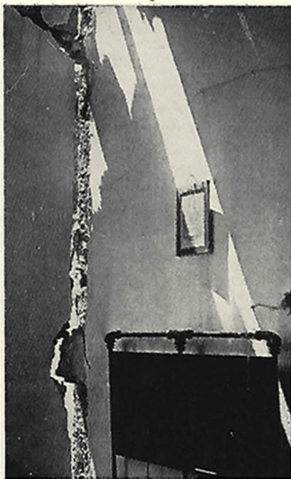
TERNI - Crollo in Via Tiacci. La Madonna protettrice: il crollo avveniva immediatamente dopo l'ultimazione dello sgombero ordinato dai Vigili del Fuoco.
